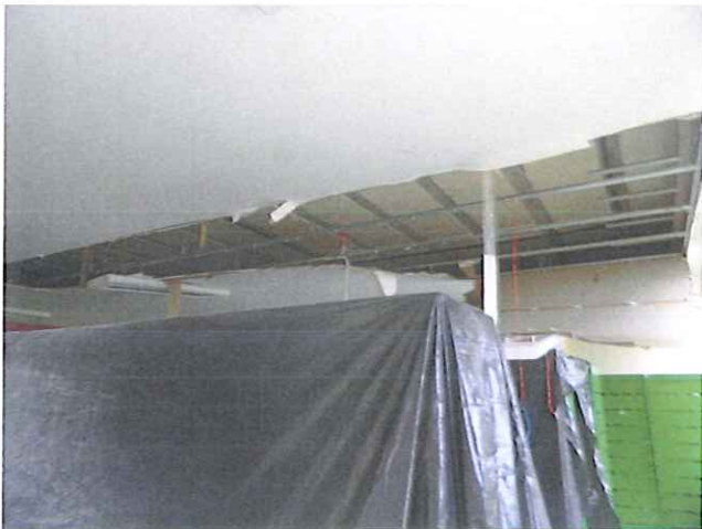
Fig.05: Desabamento das placas de gesso abaixo do local do destelhamento – Bloco III;
