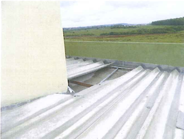
Fig.03: Vista da Cobertura – danos Bloco III
