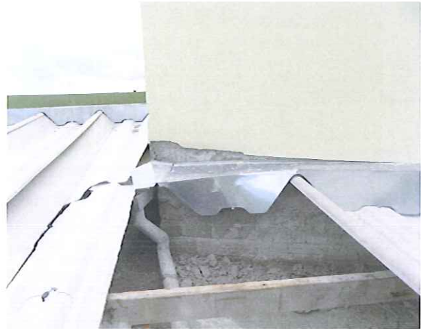
Fig.04: Rufos que se soltaram junto com as telhas;
