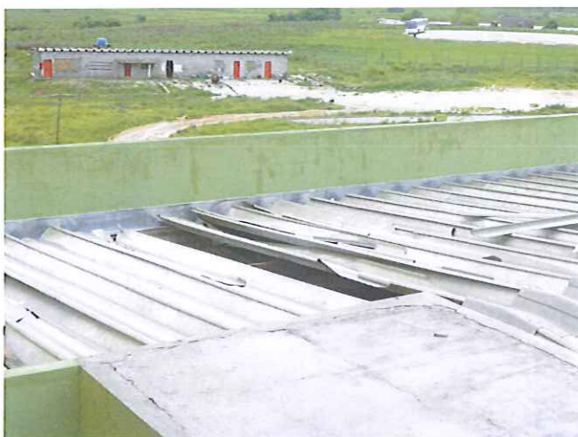
Fig.01: vista Geral da Cobertura – danos Bloco III;
