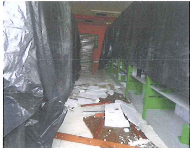
Fig.06: Área da Biblioteca piso com água e materiais acumulados;
