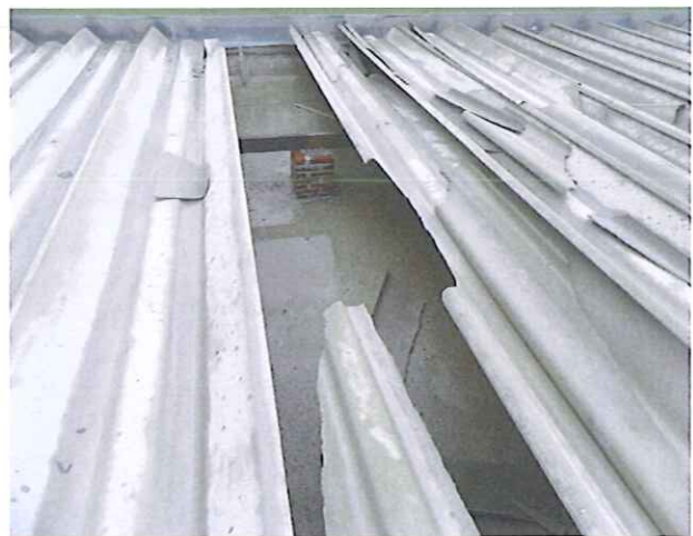
Fig.02: Alagamento abaixo cobertura Bloco III;
